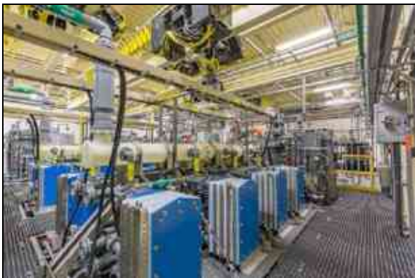
Рис. 78. Блоки електролізної установки з очищення води
