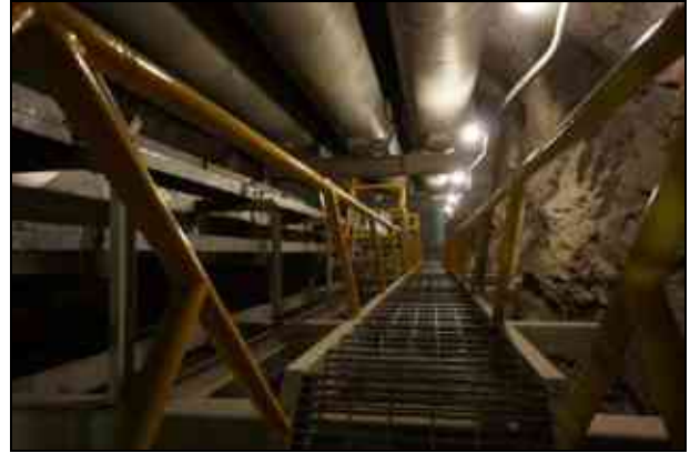
Рис. 51. Труби дериваційної ГЕС Churchill Falls (Канада), які доставляють воду до турбін
