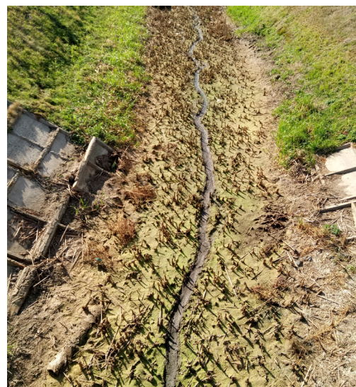
Рис. 2. Канал трапецієподібної форми (східна околиця с. Бурківка) (фото Філоненка Ю. М.). Fig. 2. A trapezoidal channel (the eastern outskirts of the village of Burkivka) (photo by Yu. M. Filonenko).
