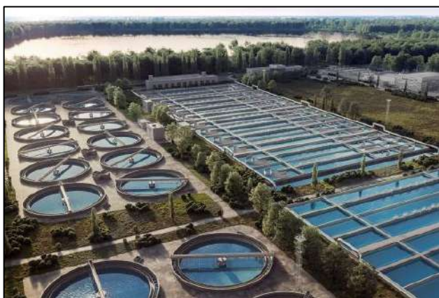
Рис. 60. Блок біологічної очистки Бортницької станції аерації
